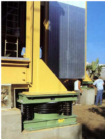
Bild 17 Erdbebenschutz eines Bauwerks in Kalifornien (Quelle: GERB) [22]
